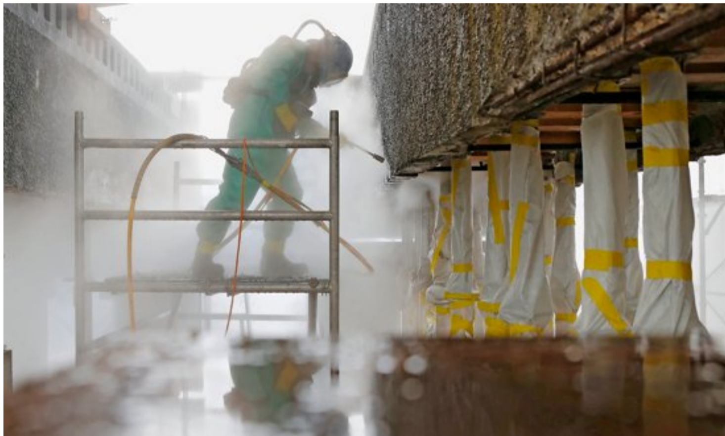
Wasser als Werkzeug: Mit einem Druck von 2100 Bar schießt das Wasser gegen den Beton und legt so die verrosteten Armierungen frei. Bilder Beat Matthys
