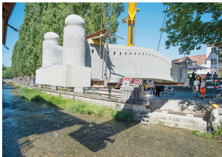
Wieder an ihrem alten Platz: Eine der beiden renovierten Lyssbachbrücken wird gesetzt. Stefan Anderegg
